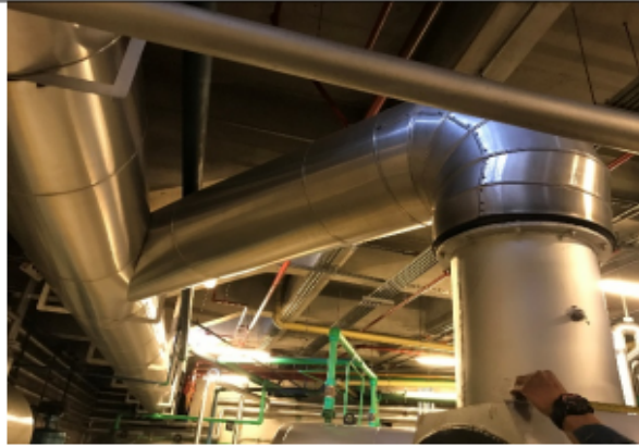
Fotografía No 5. Ducto de descarga.
