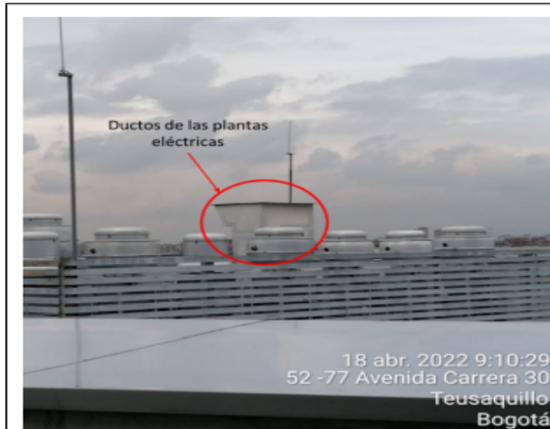
FOTOGRAFÍA No. 9. Ductos plantas eléctricas
