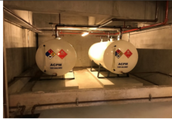
Fotografía No 6. Tanques de ACPM.
